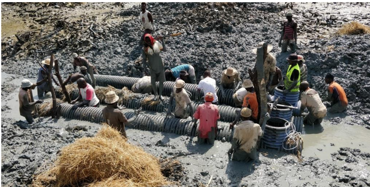
Pose de tubes de 500 mm dans une rizière de Binibaque pendant la visite d'échange
