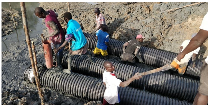
Tabanca de Eossor: 3 tubos de 500 mm e 3 válvulas instaladas
