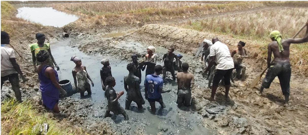
Cadique Maila: Enchimento do dique de cintura, com 1 tubo e 1 Te de 300 mm, já instalados
