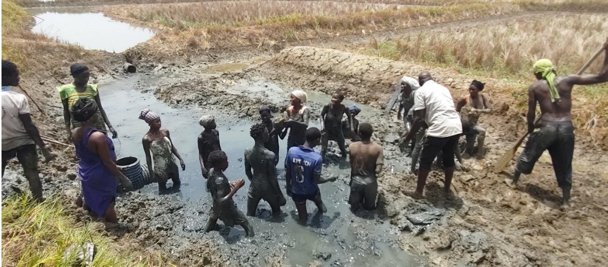
Cadique Maila: Enchimento do dique de cintura, com 1 tubo e 1 Te de 300 mm, já instalado
